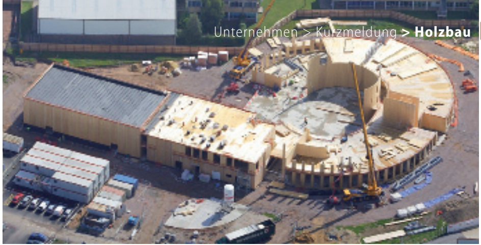
In nur 18 Wochen wurden die Brettsperrholz-Elemente in Norwich mit zwei Kränen aufgebaut
